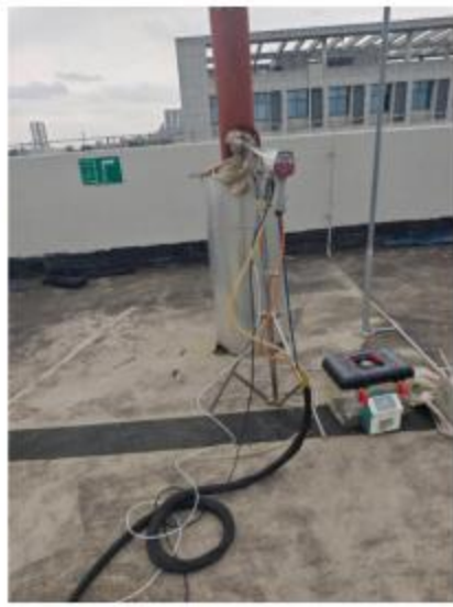
AC#807 车间废气排气筒出口
